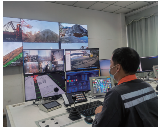
配备最强大脑——工业 IDC 数据处理中心
